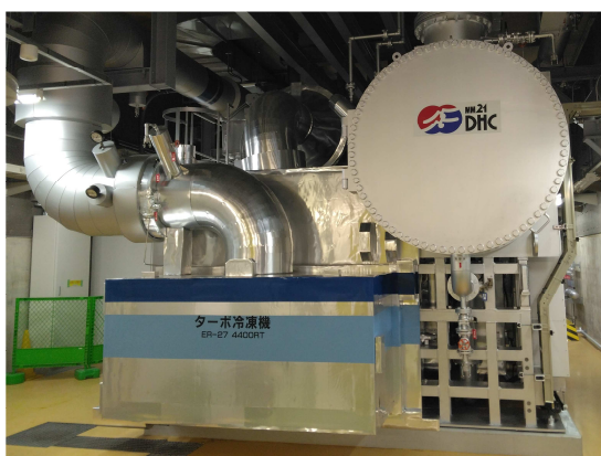
電動ターボ冷凍機(4,400RT)
