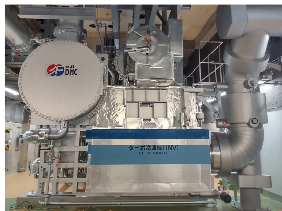
インバータターボ冷凍機 1基 (5,400RT)
