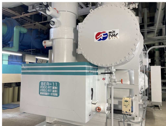
蓄熱用電動ターボ冷凍機(蓄熱時 2,000RT)
