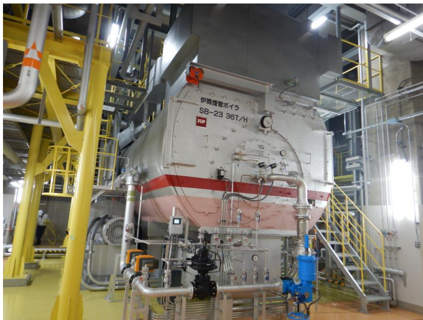
2019年12月 第2プラントに増設した日本最大の炉筒煙管ボイラ
